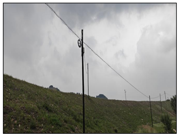
图 2-21 坝体处摄像头
