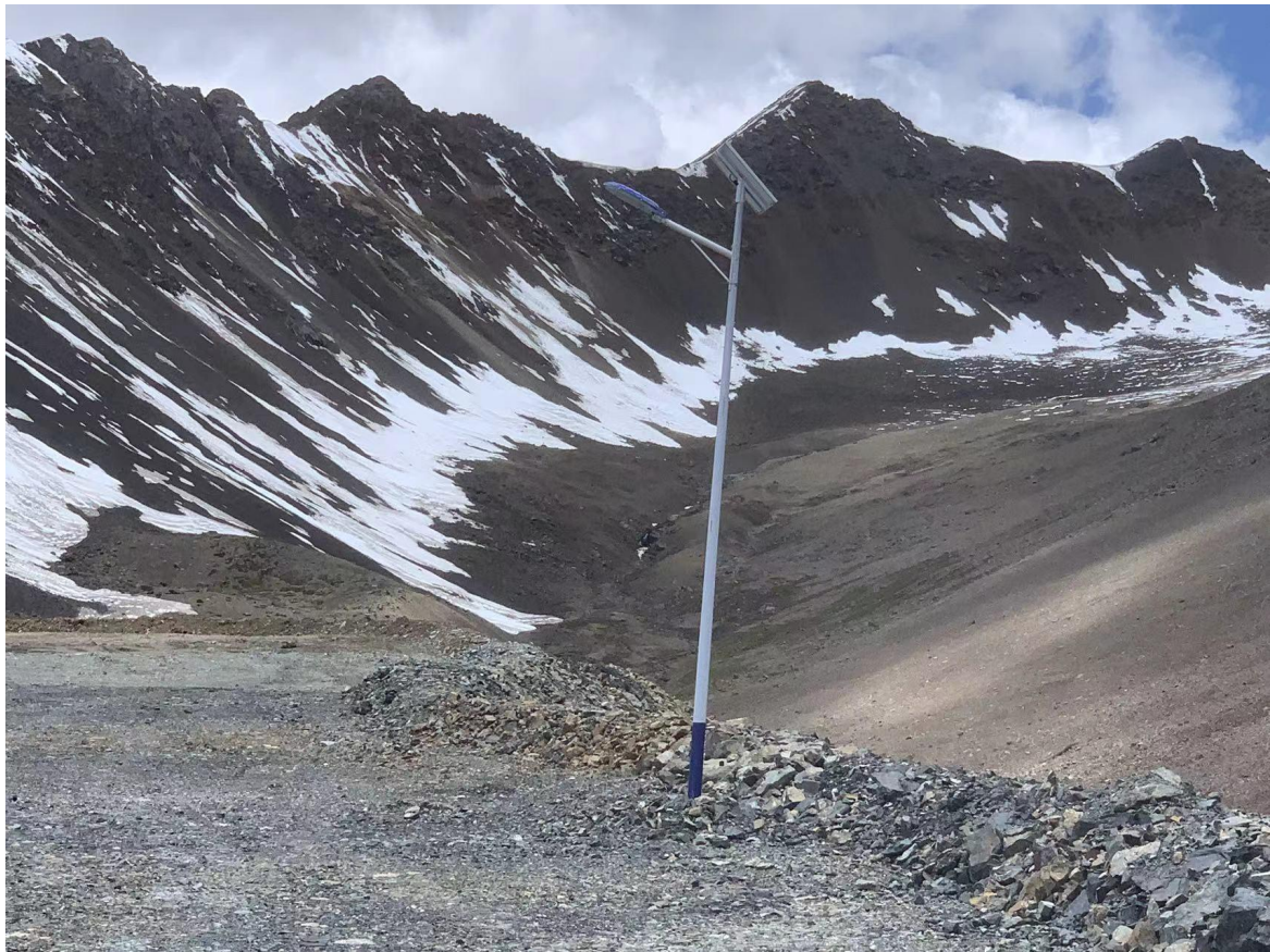
图 2-20 排土场太阳能照明
