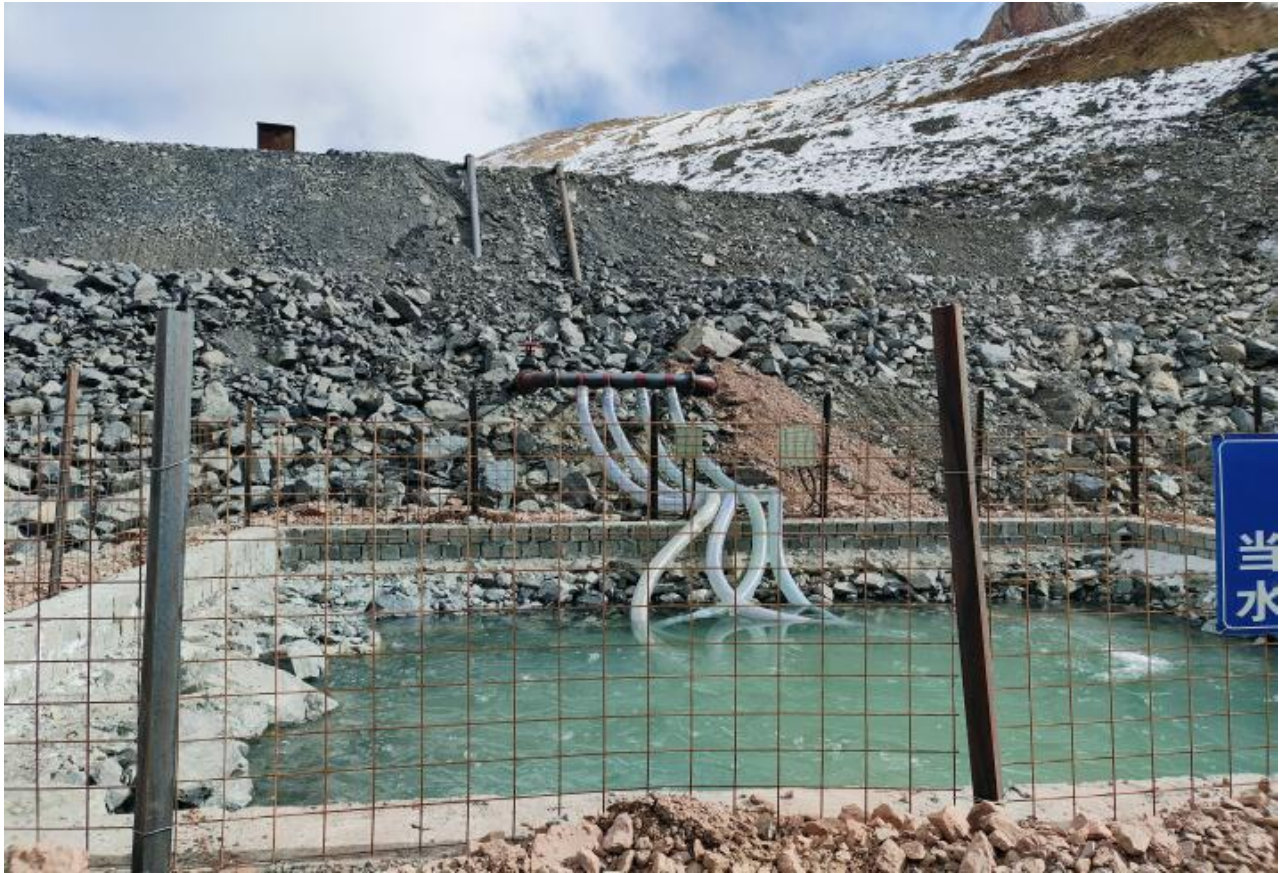
图 2-15 集水池及水泵
