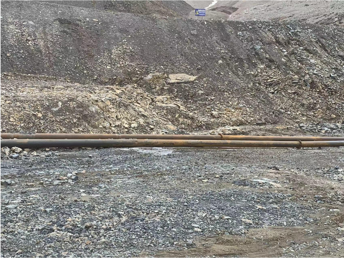
图 2-16 两条排水管路
