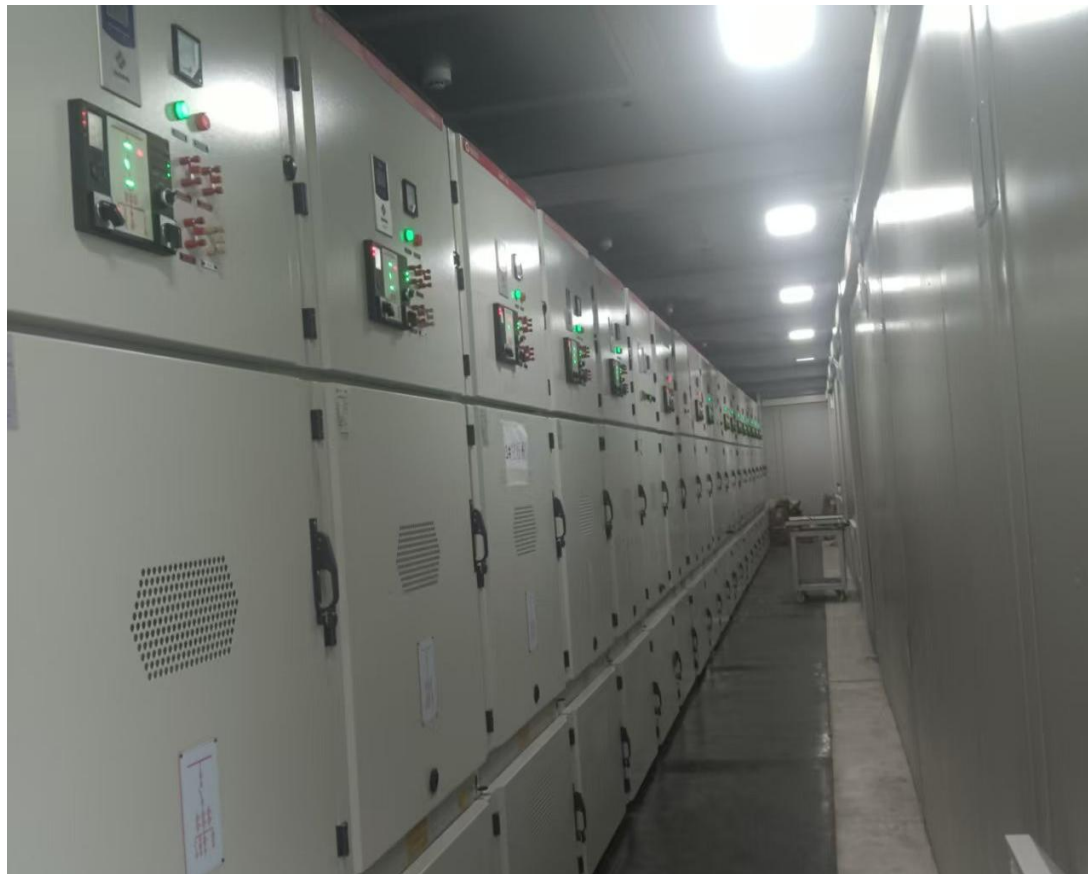
变电所开关柜
