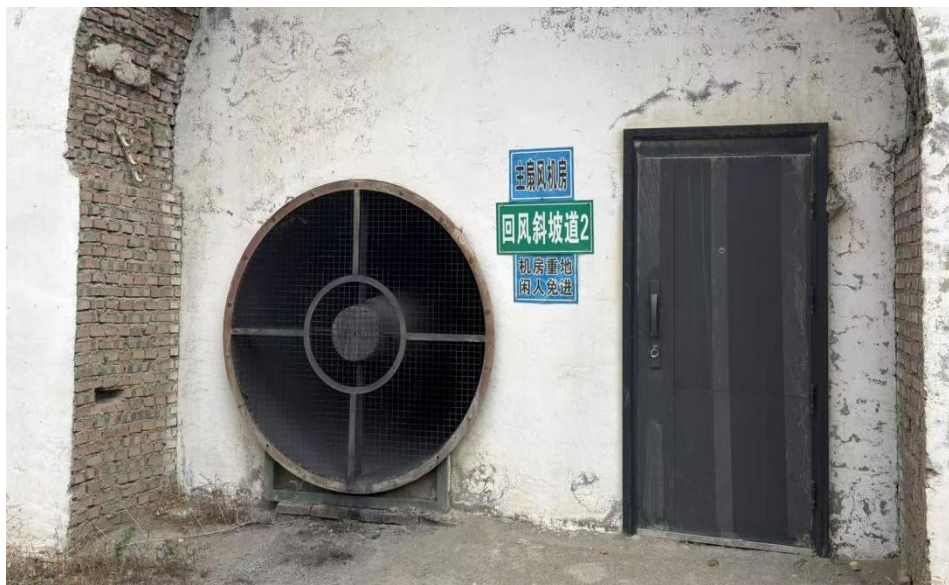
图 2-12 回风斜坡道 2 风机房
