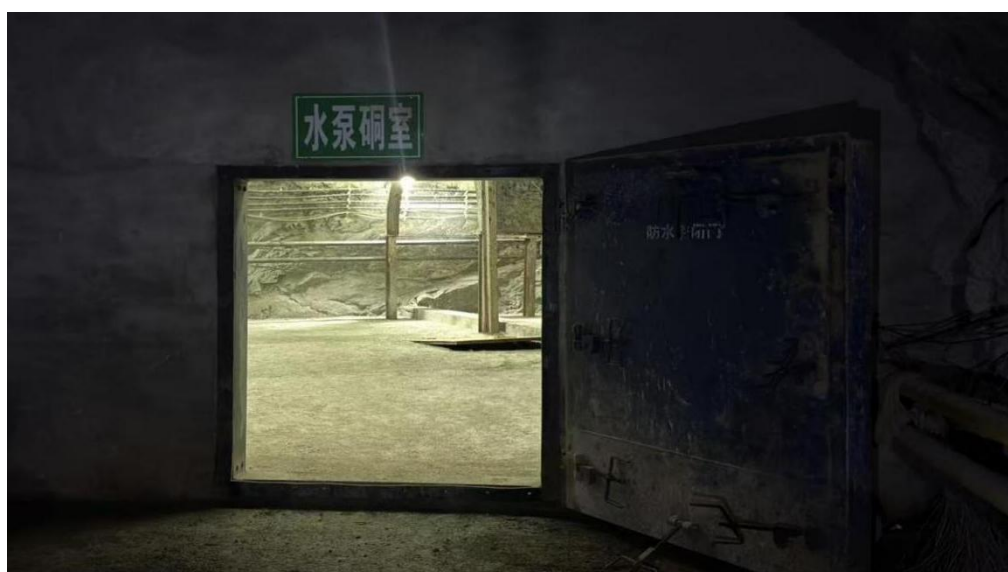
图 2-17 水泵硐室防水门
