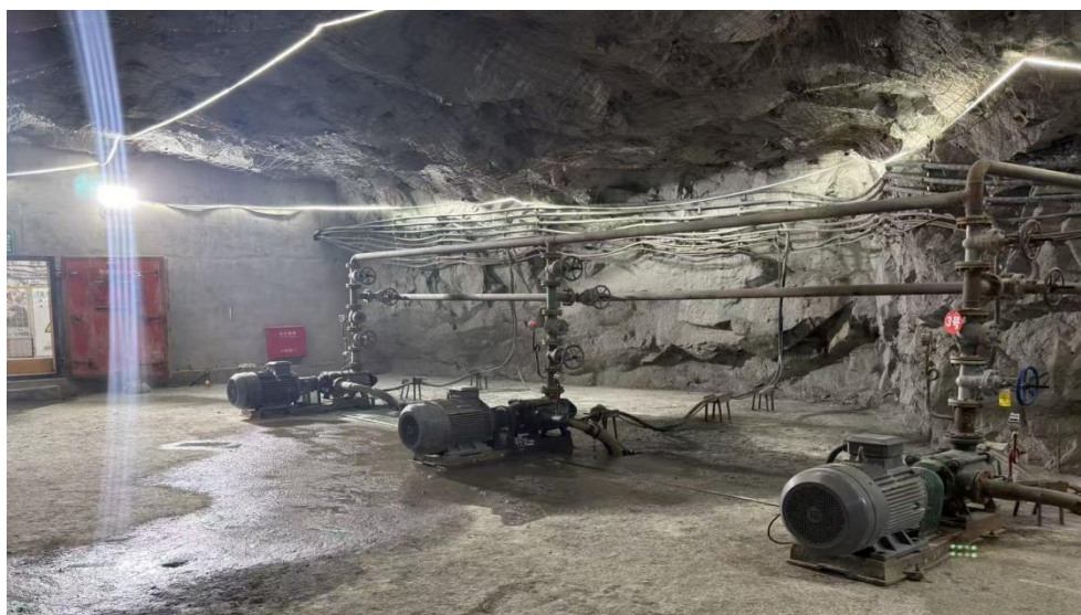
图 2-15 504m 中段水泵房
