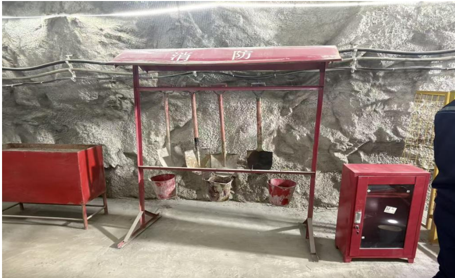
图 2-19 水泵房内消防器材
