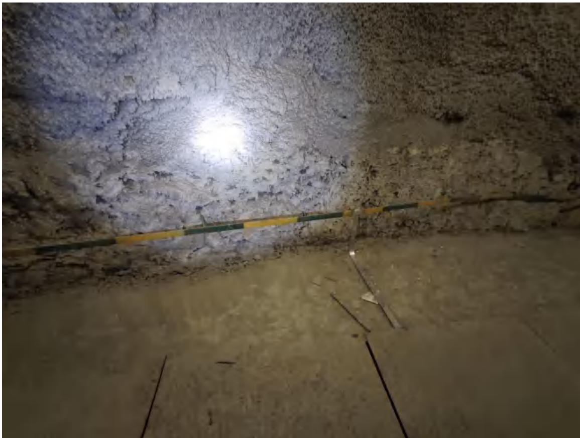
图 2-28 -285m 中段采区变电所内设备外壳接地
