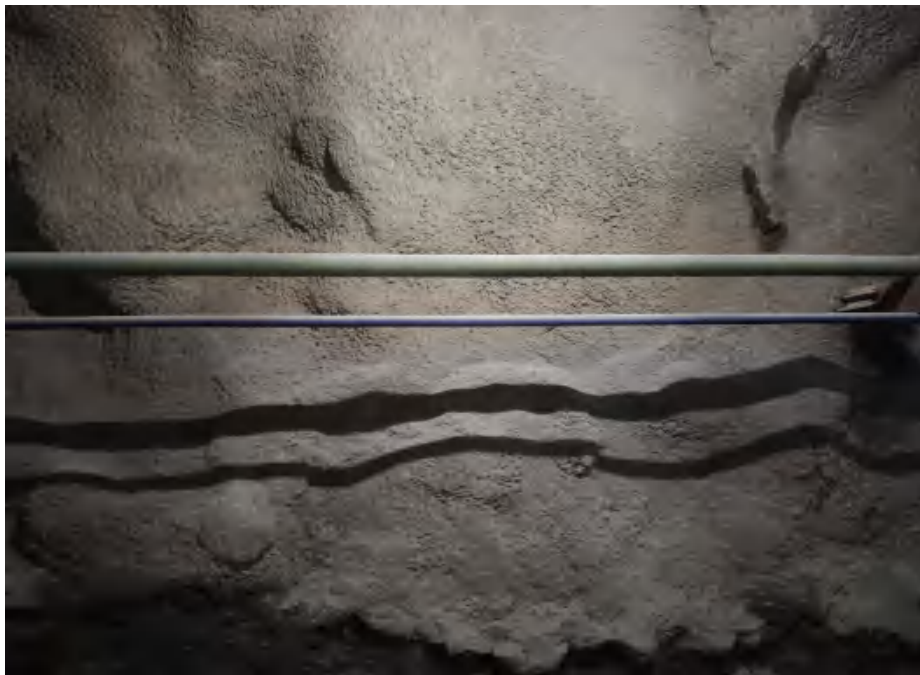
图 2-25 -285m 出矿水平压风供水管路
