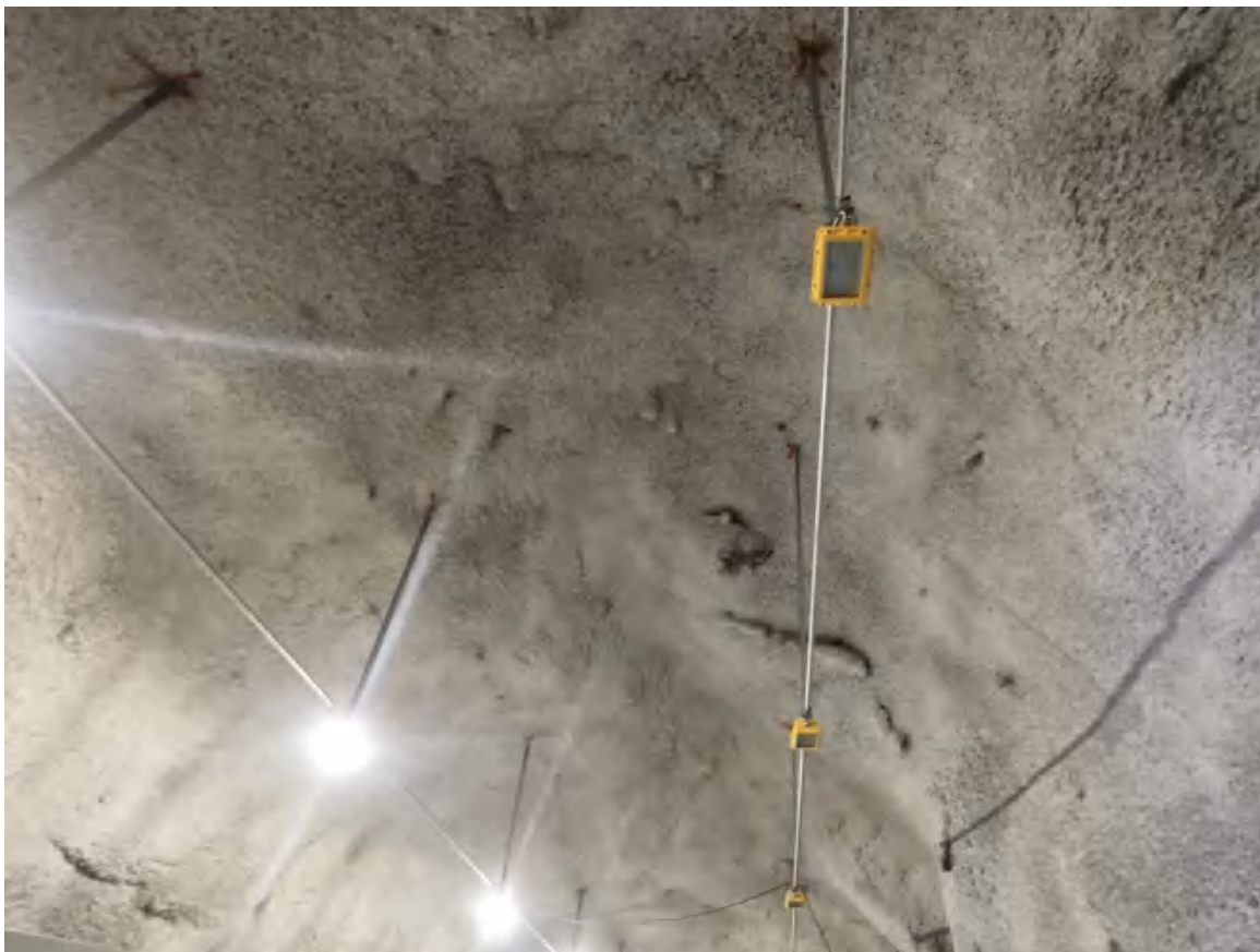
图 2-29 -285m 中段采区变电所内应急照明
