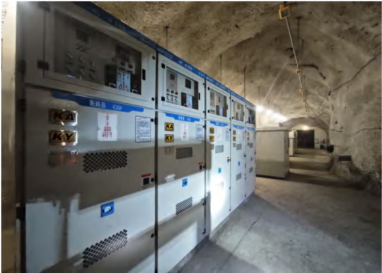
图 2-27 -285m 中段采区变电所
