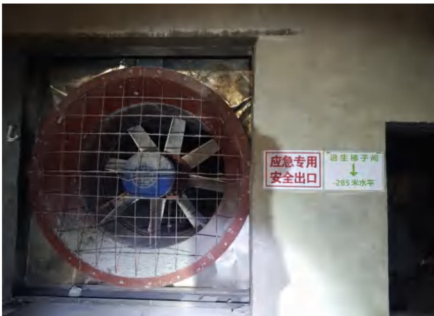
图 2-19 3#采区西回风天井风机
