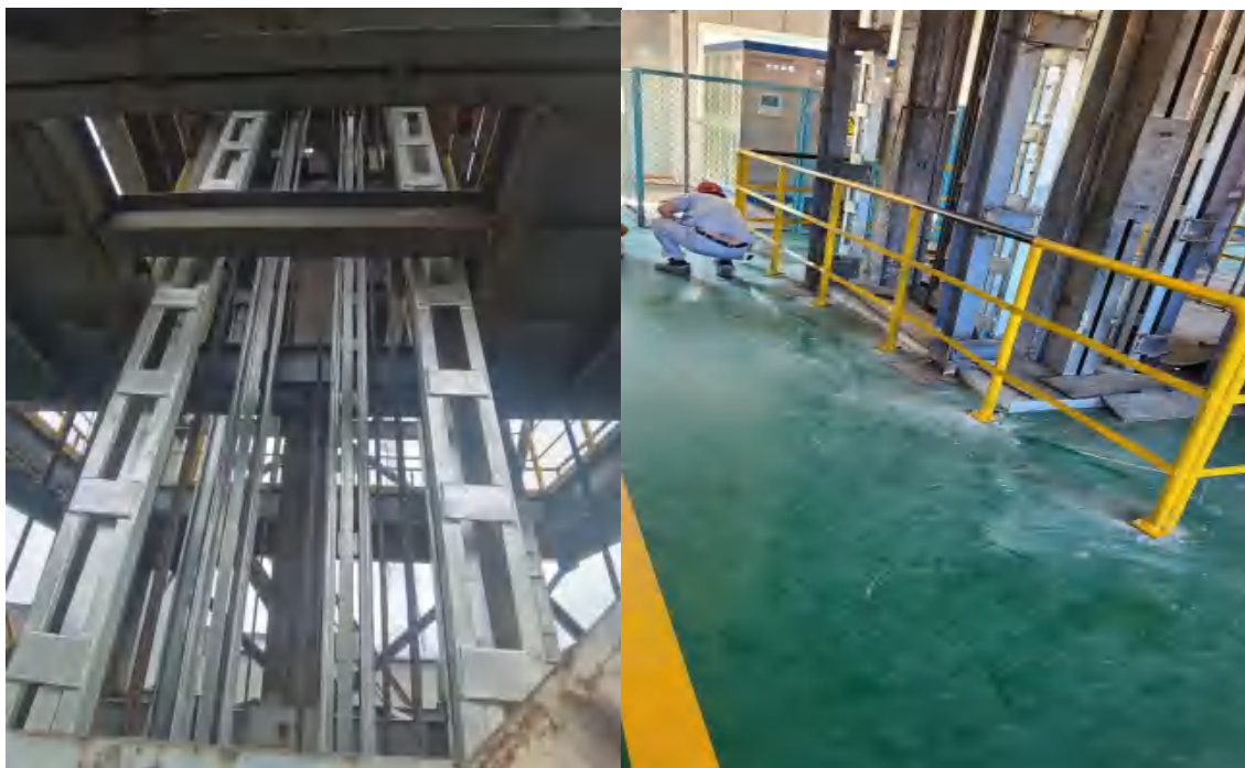
图 2-14 过卷缓冲装置、罐笼防坠装置
