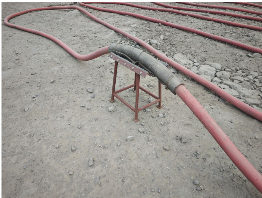
图 2.5.8-1 电缆接头支架
