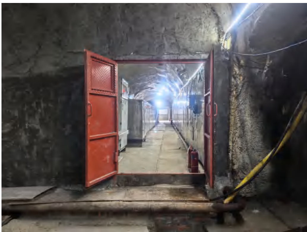
图 3.2-10 0m 配电硐室防火栅栏门
