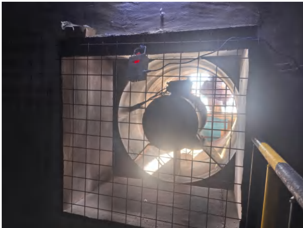
图 3.5-7 北回风斜井通风机出口
