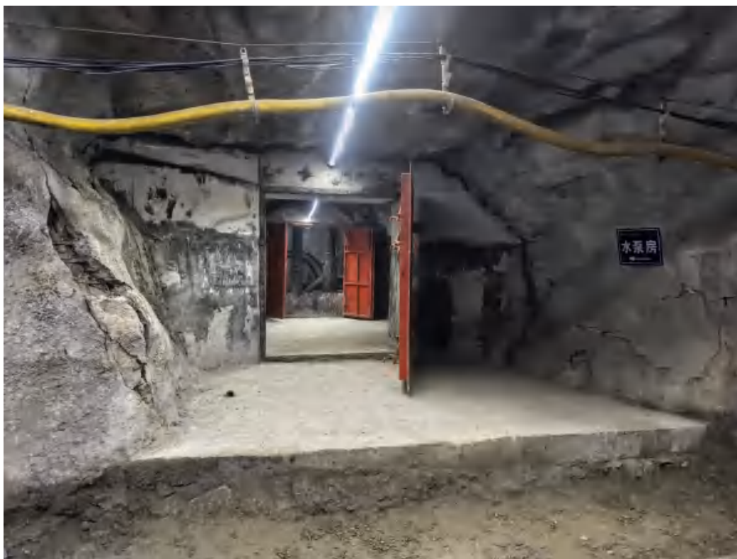
图 3.4-4 0m 中段水泵房出口及防水门
