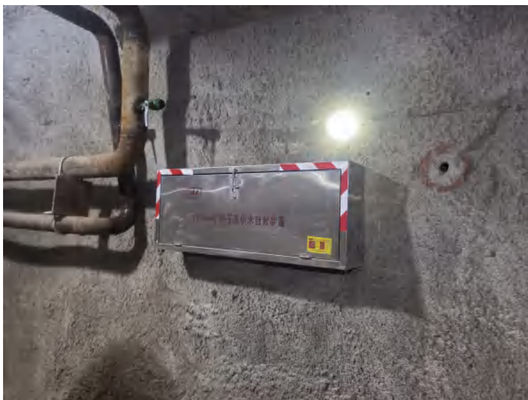
图 3.9-8 压风自救、供水施救装置（一）
