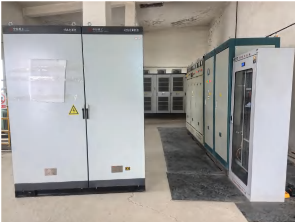
图 3.7-7 2 号提升机房配电室配电柜
