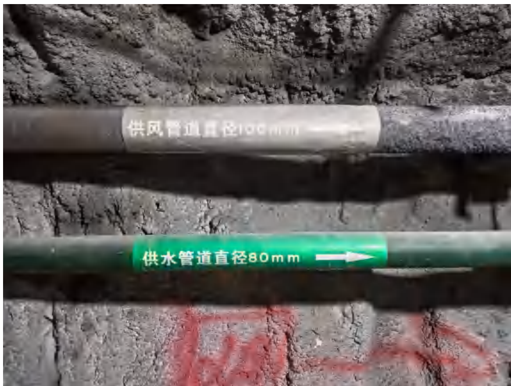
图 3.8-1 井下压风供水管路敷设
