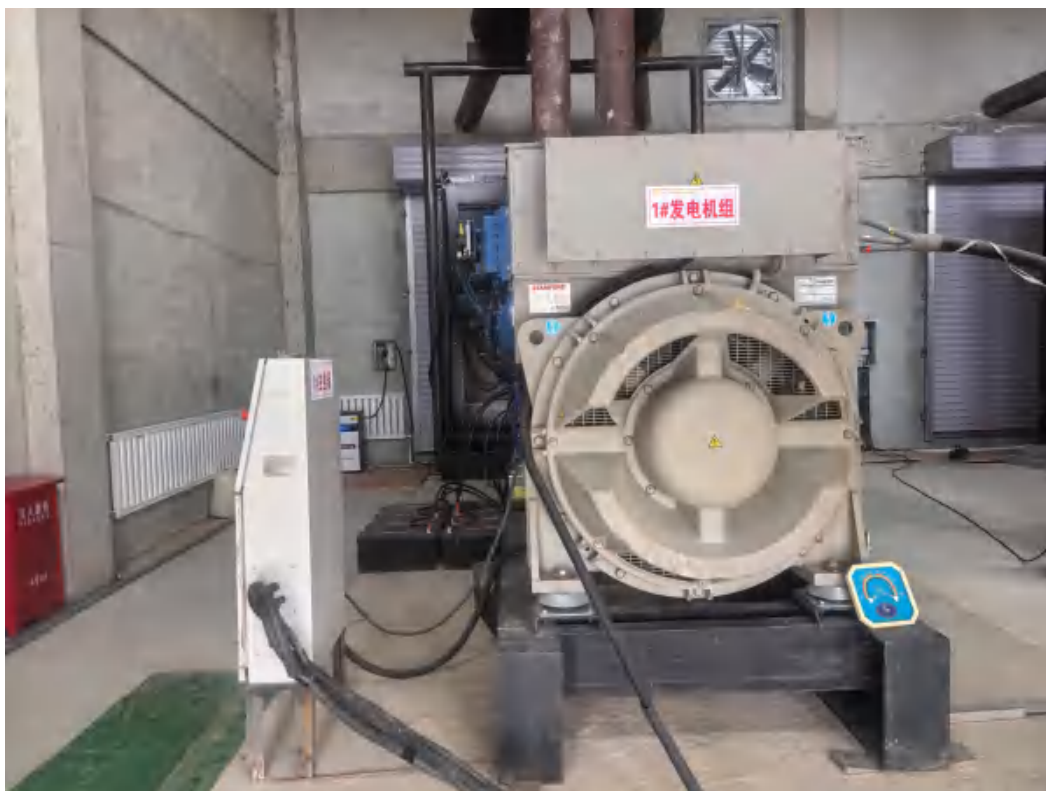
图 3.7-4 35kV 变电站内 1#发电机
