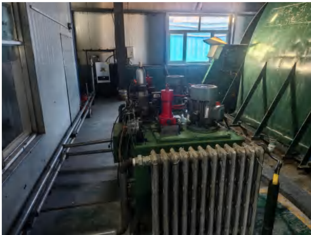
图 3.3-4 2 号竖井液压站
