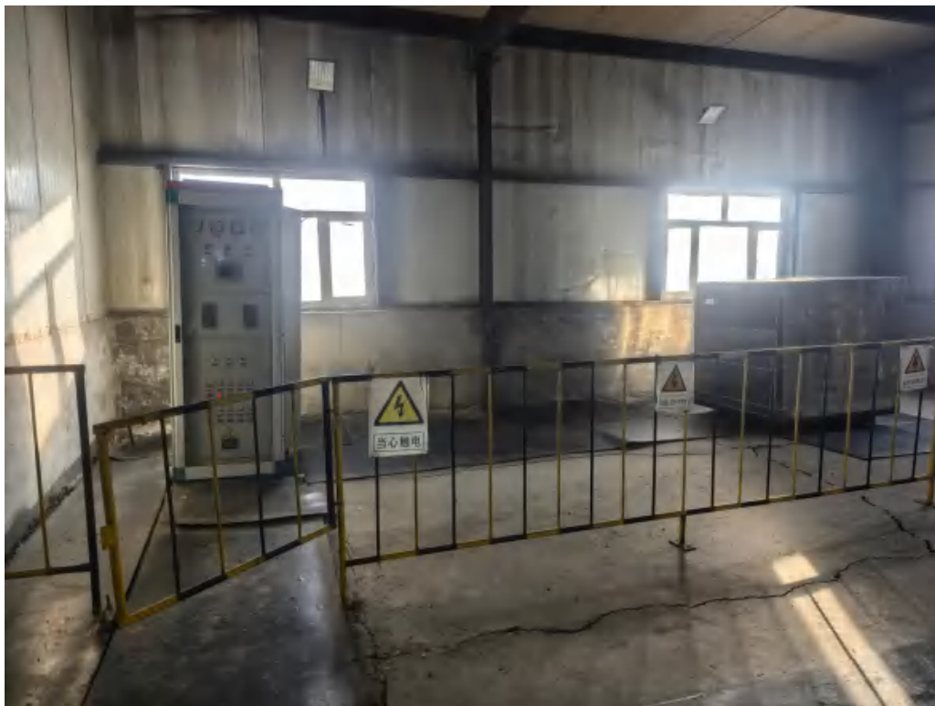
图 3.7-8 3 号提升机房配电室变压器
