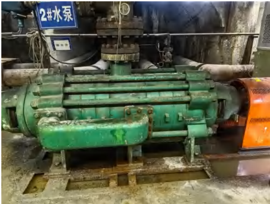
图 3.4-2 0m 中段水泵房内 2#排水泵
