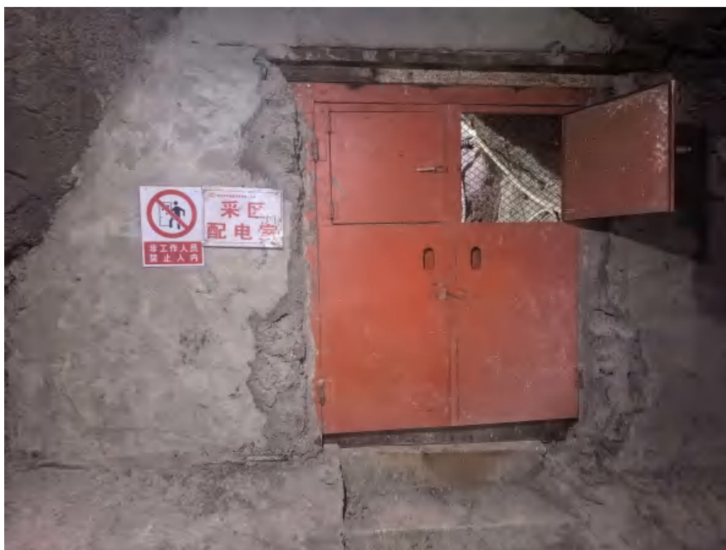
图 3.2-11 350m 采区变电室
