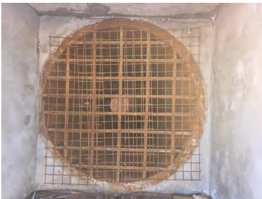
图 3.5-2 南回风井通风机出口
