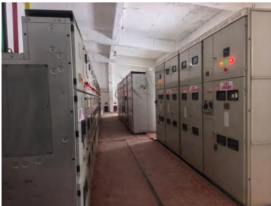
图 3.7-3 35kV 变电站配电柜
