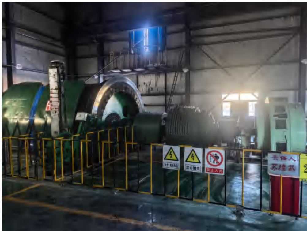
图 3.3-1 2 号竖井提升机、电机、减速器
