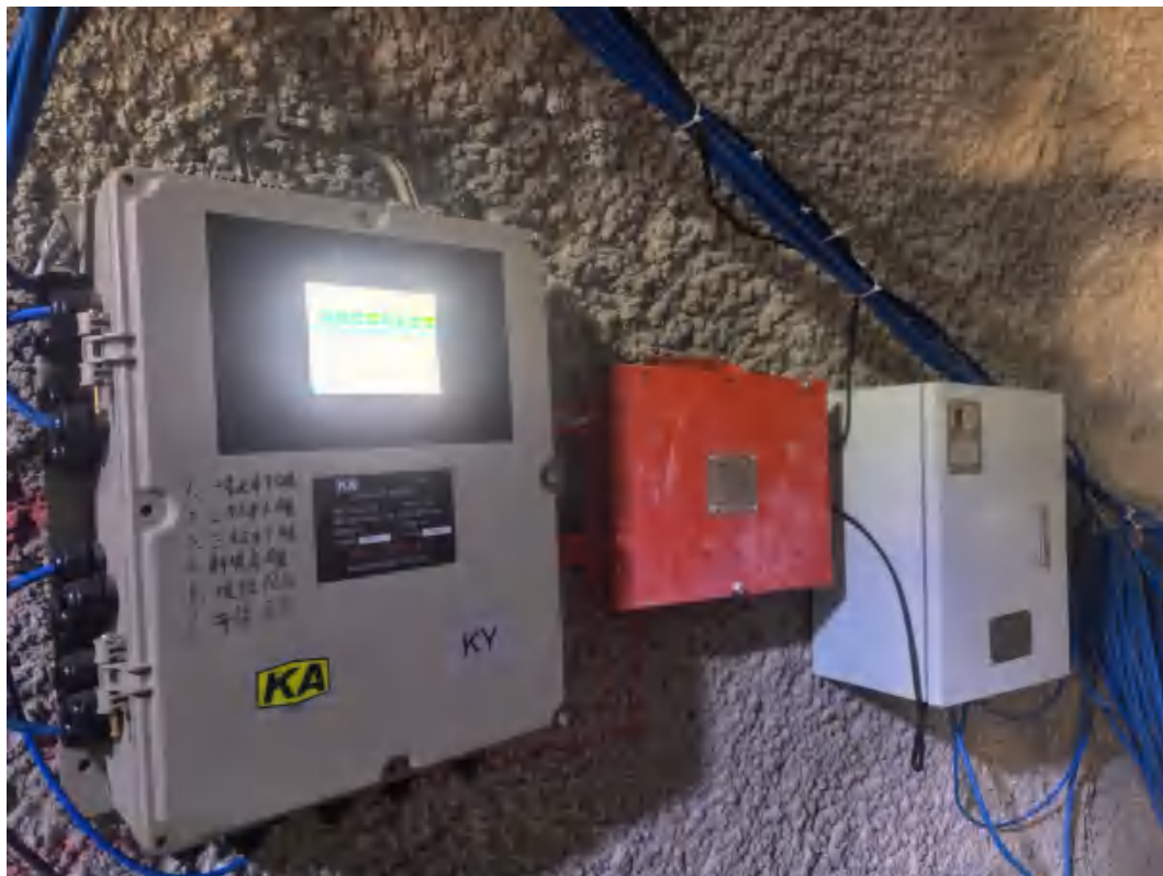
图 3.5-9 北回风斜井通风机监测设施配电箱
