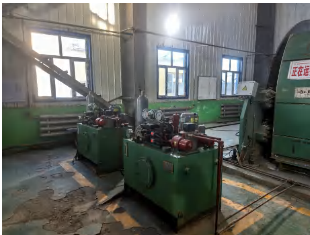
图 3.3-6 5 号竖井液压站
