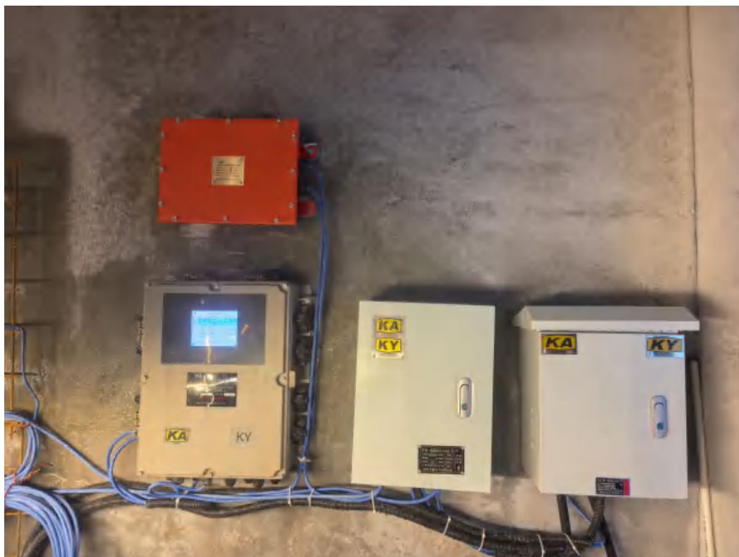
图 3.5-4 南回风井通风机监测设施配电箱
