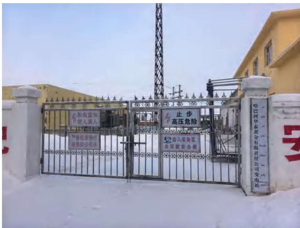
图 3.7-1 地表 35kV 变电站
