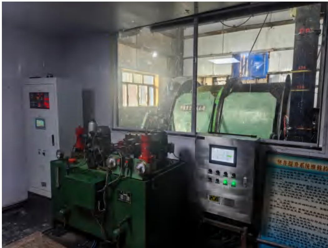
图 3.3-5 3 号竖井液压站
