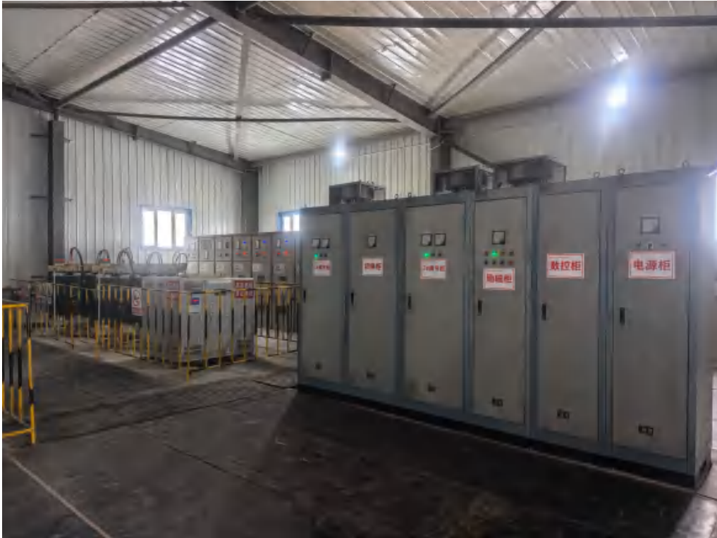
图 3.7-10 5号提升机房配电室变压器、配电柜
