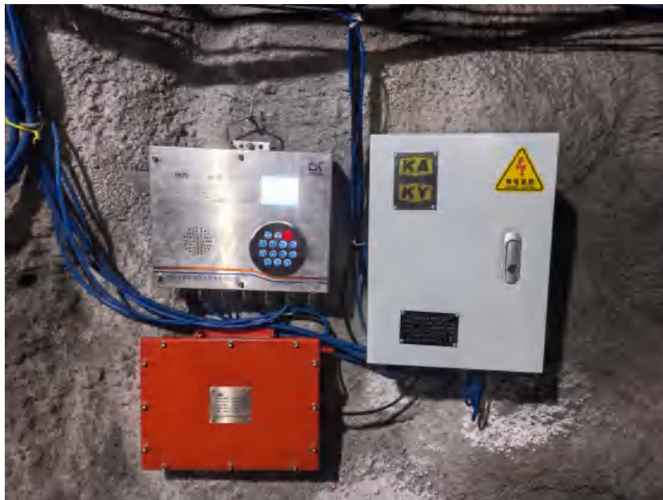
图 3.9-5 井下六大系统配电箱、应急广播系统
