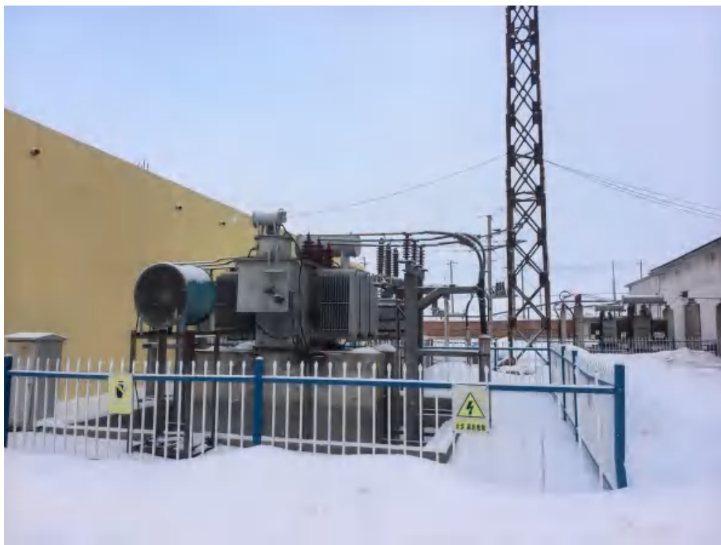
图 3.7-2 35kV 变电站内 2 台主变压器
