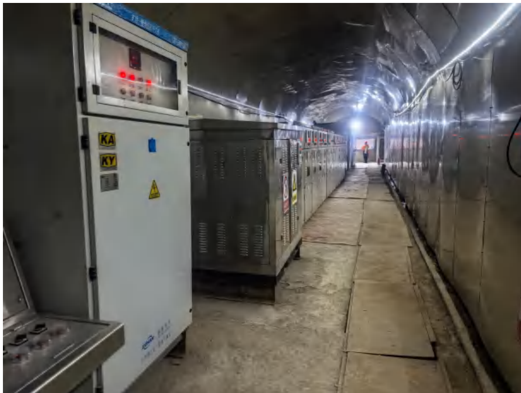
图 3.4-6 0m 中段水泵配电柜
