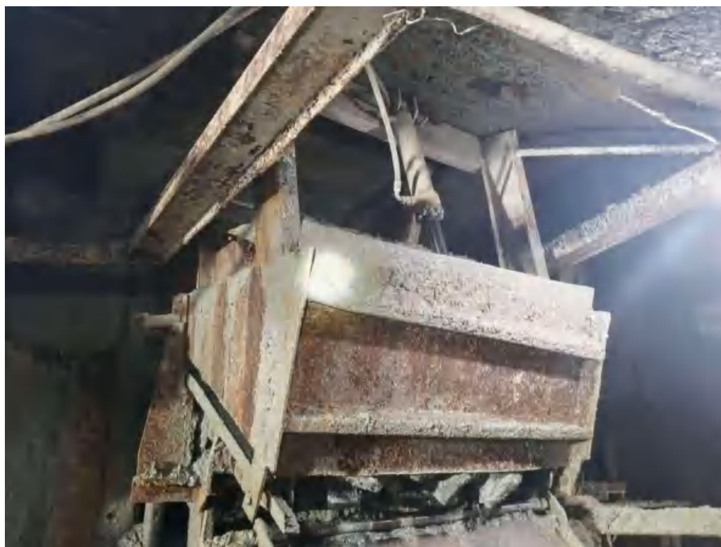
图 3.3-13 主溜井底部放矿设施
