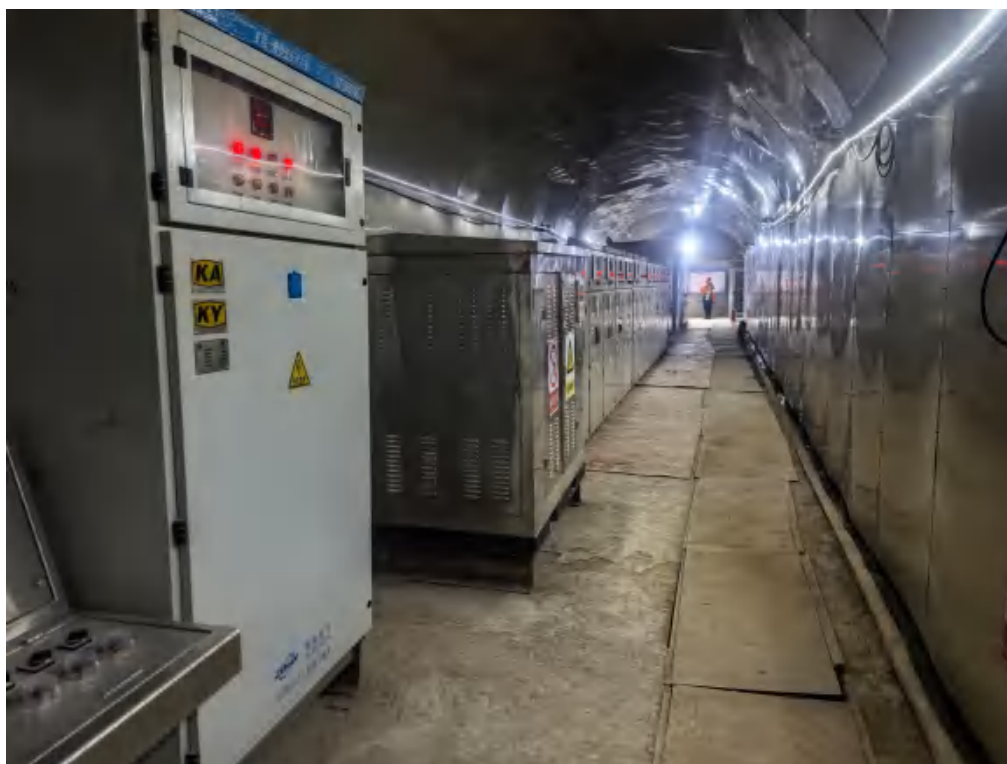
图 3.7-13 0m 水泵房变电所内变压器、配电柜
