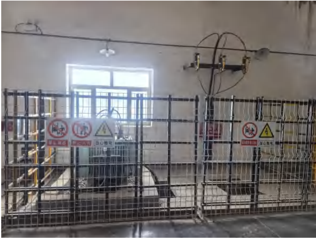
图 3.7-6 2 号提升机房配电室变压器
