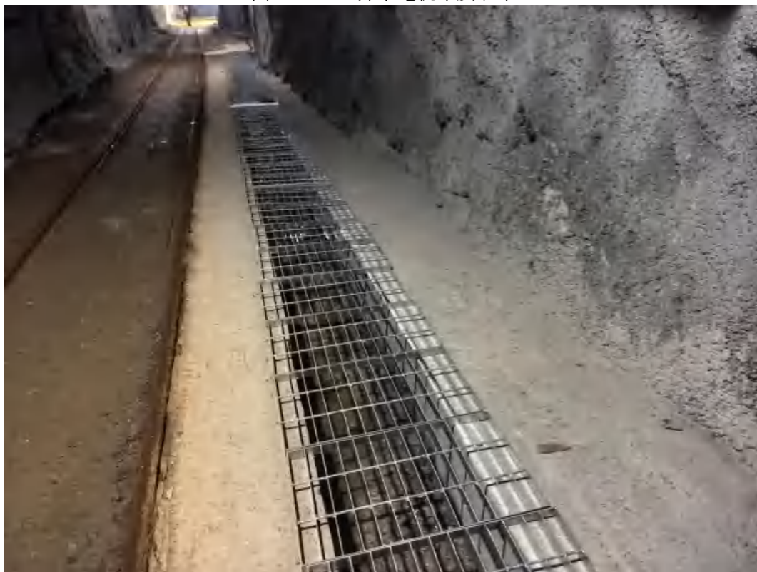
图 3.3-11 井下中段人行道及水沟盖板
