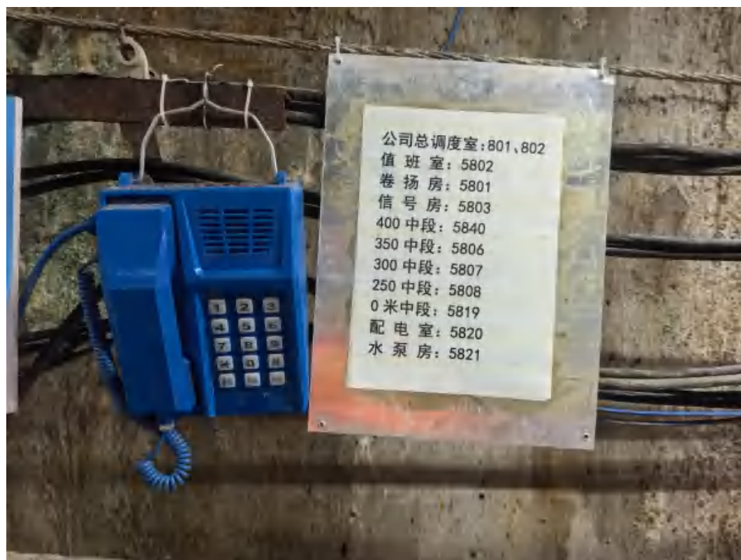
图 3.9-10 井下矿用电话、通讯录
