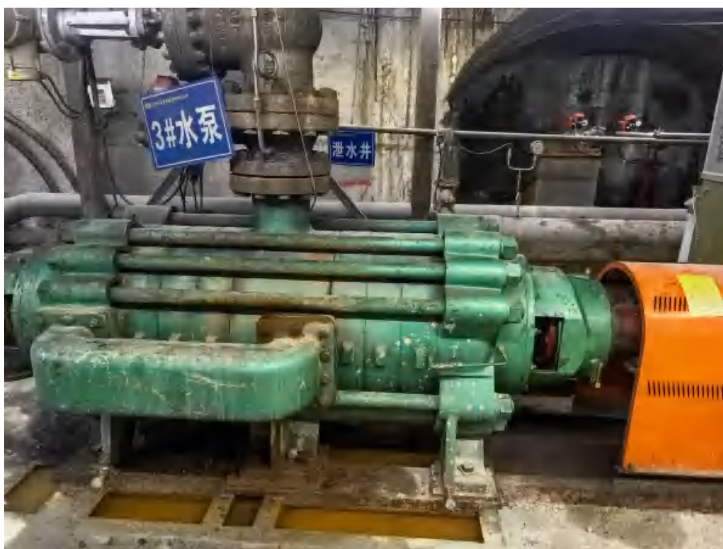
图 3.4-3 0m 中段水泵房内 3#排水泵
