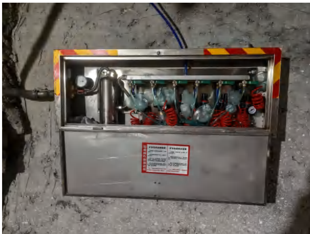
图 3.9-9 压风自救、供水施救装置（二）
