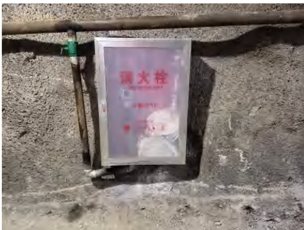
图 3.8-2 井下采区斜坡道消防设施
