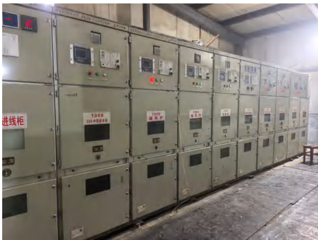
图 3.7-9 3 号提升机房配电室配电柜
