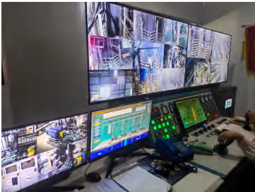
图 3.3-7 2 号井提升机操作台
