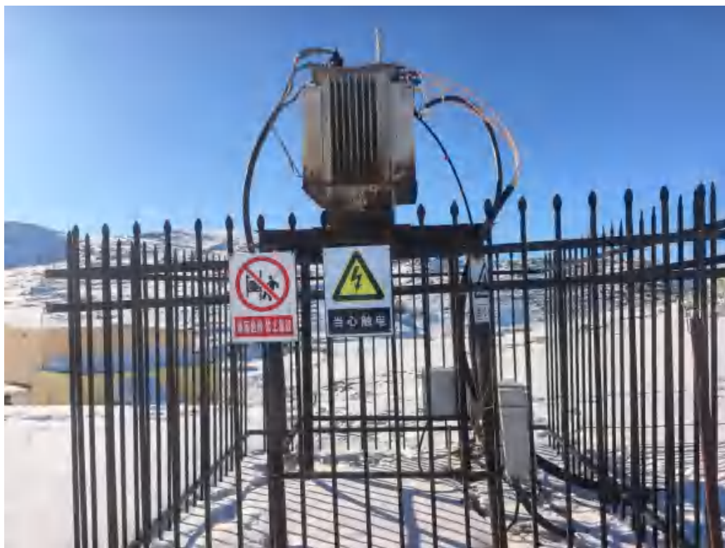
图 3.7-12 北回风斜井变压器
