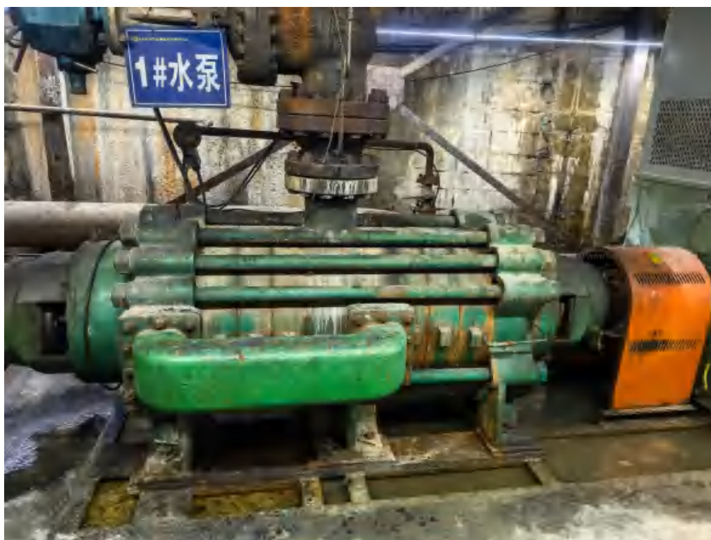
图 3.4-1 0m 中段水泵房内 1#排水泵
