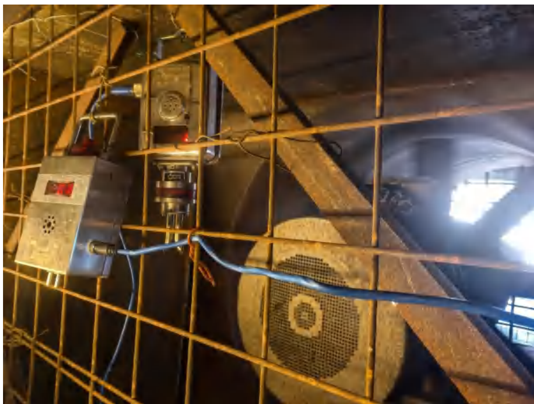
图 3.5-5 南回风井通风机监测设备
