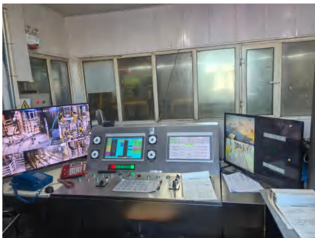
图 3.3-8 3 号井提升机操作台
