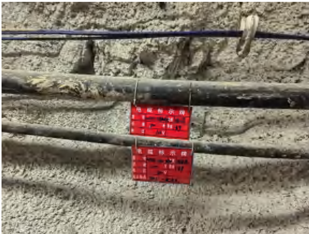
图 3.7-14 井下供电电缆及铭牌
