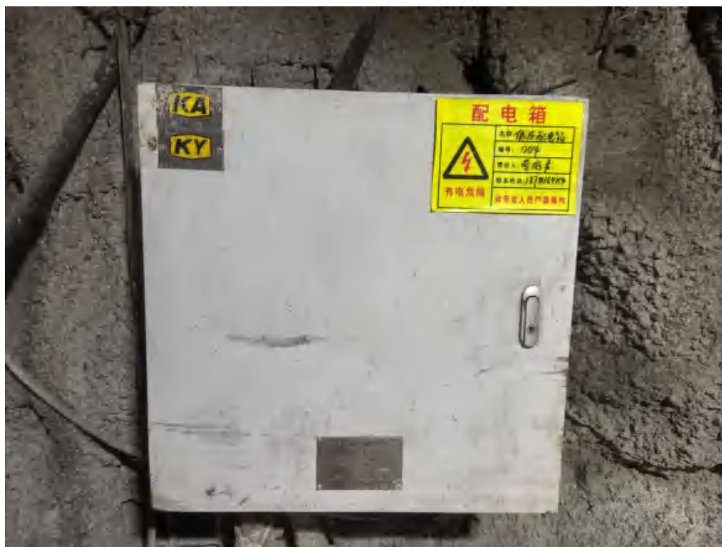
图 3.7-15 井下低压配电箱
