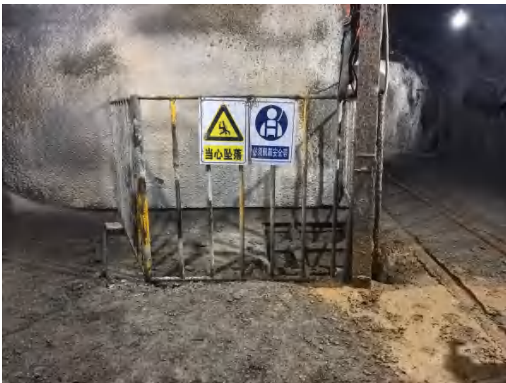
图 3.3-14 中段溜井顶部设施
