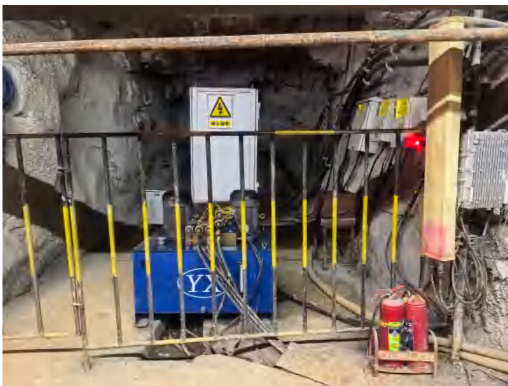
图 3.8-3 井下硐室消防设施
