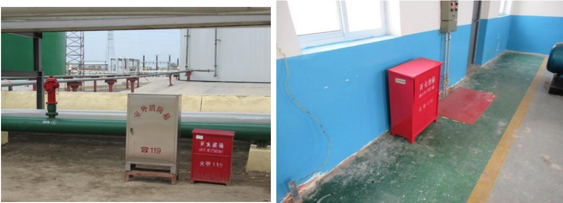
图 2.2.3-17 曙四联合站代表性消防器材照片
