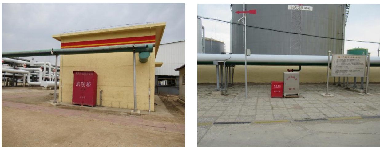
图 2.2.3-25 曙五联合站代表性消防器材照片
