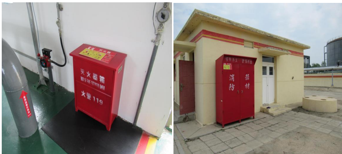
图 2.2.3-9 曙一联合站代表性消防器材照片
