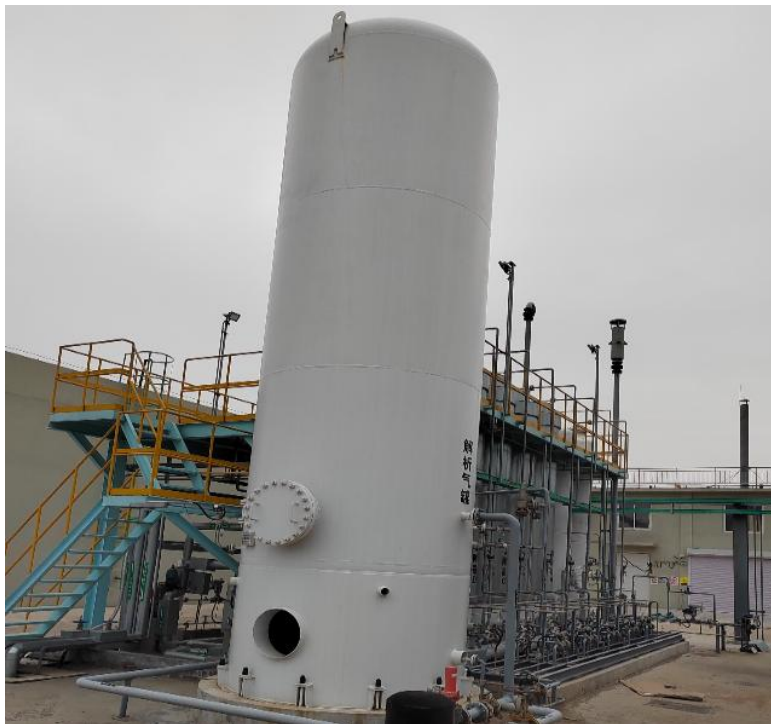
图 2.7-1 甲醇制氢装置
